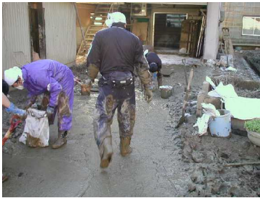
庭先からヘドロ撤去
