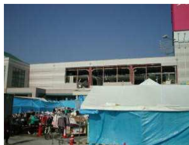
外壁が落下、テントで営業の店舗
